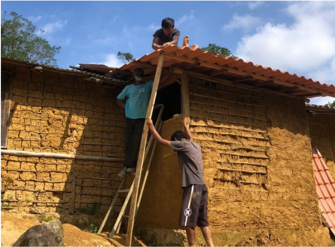
Foto 5 - Além do sistema de esgotamento, foram construídos banheiros utilizando dos saberes locais, mantendo as tradições da comunidade.
