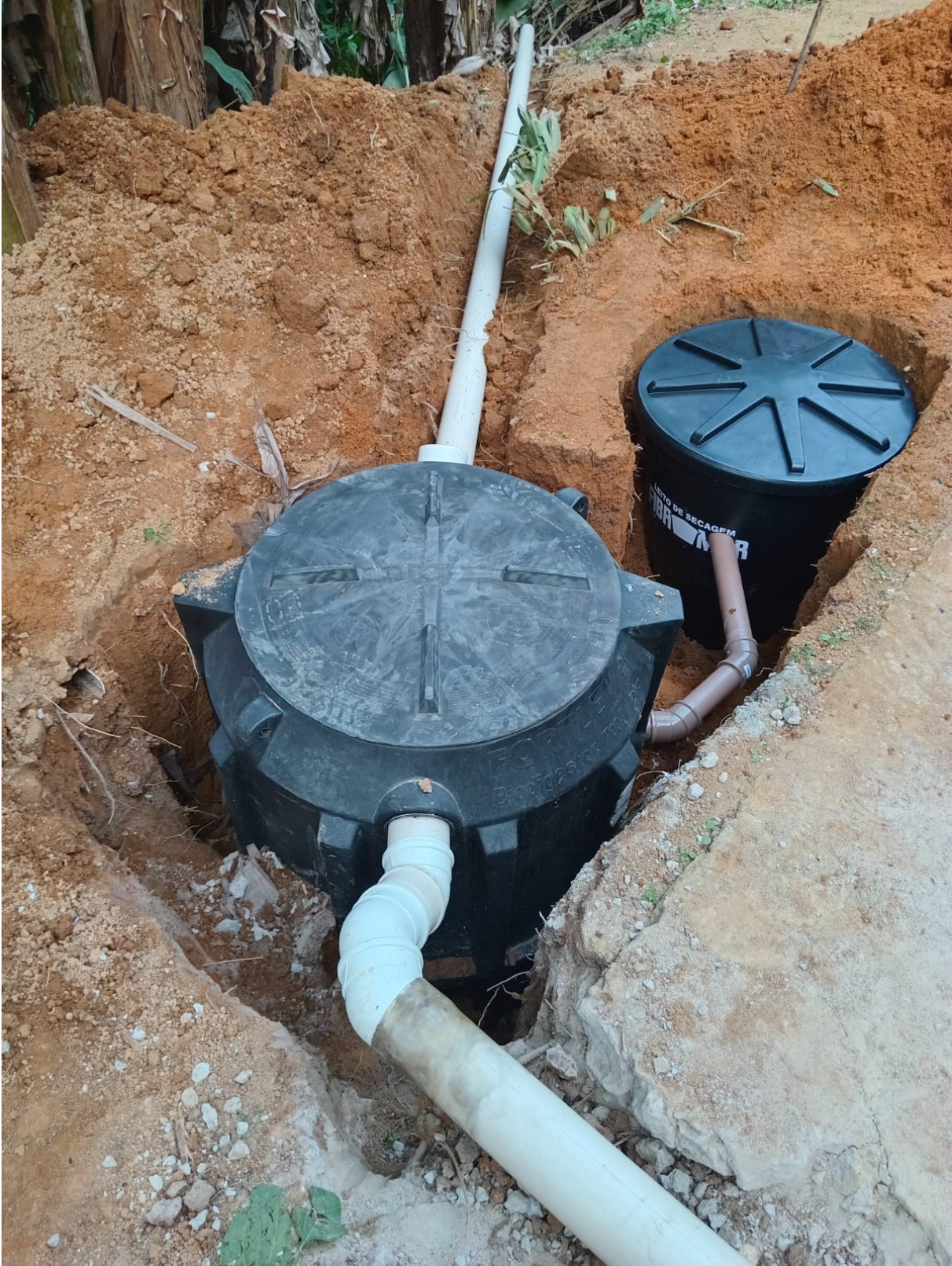
Foto 10 - Biodigestores instalados na localidade de Praia Vermelha, na Ilha Grande em Angra dos Reis/RJ. Projeto contratado com recursos do FUNDRHI.
